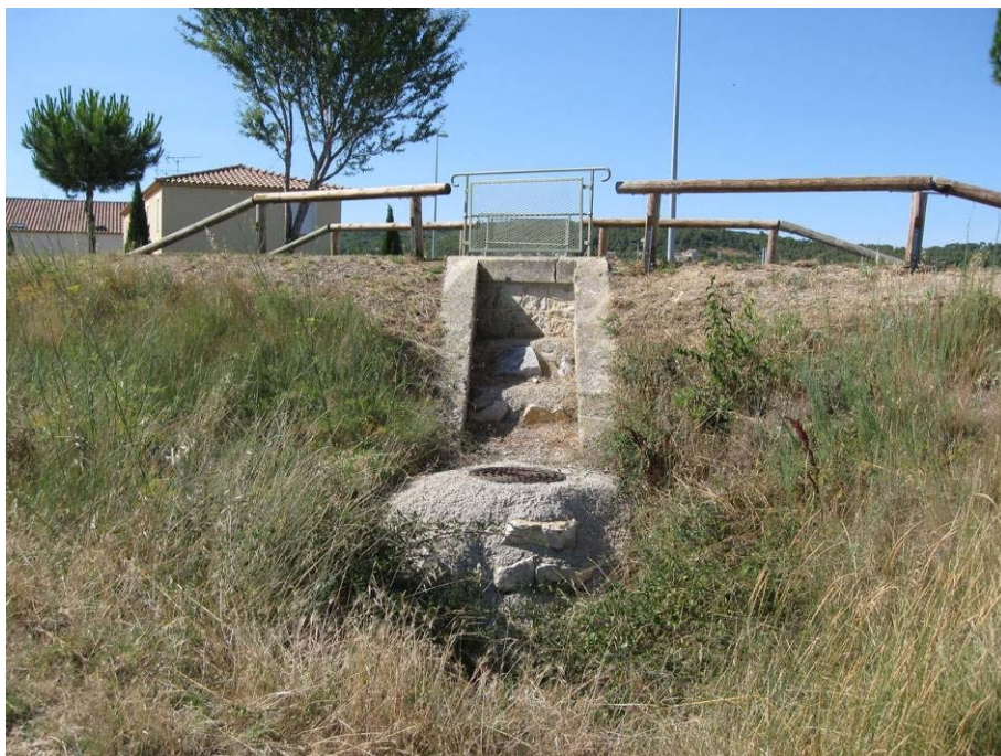
Figure 2 : Remblai transversal de l'ancienne voie ferrée, exutoire totalement obstrué.
