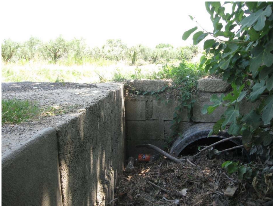
Figure 6 : Section d'un fossé réduite par des débris.
